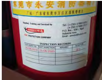
Extincteur et sa fiche d'inspection
